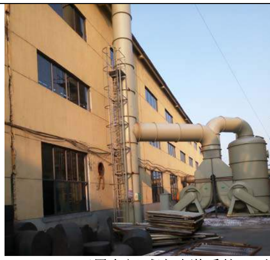
13000、8429 石墨车间碱液喷淋系统(三级)
