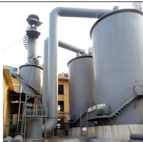
18 室+32 室焙烧炉“二级电捕焦+脱硫+湿电”处理系统
