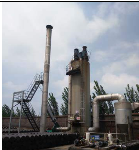
隧道窑烟气脱硫湿电除尘器
