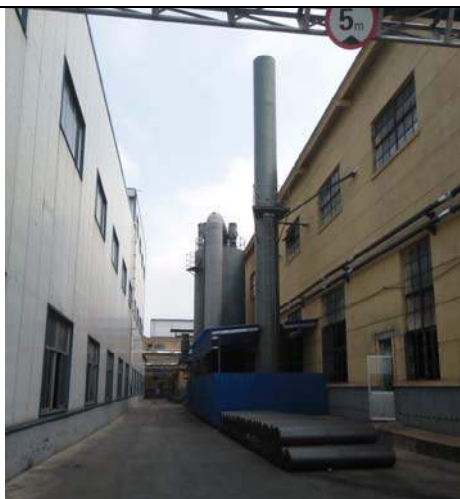
2500、3500 压型车间湿电除尘器
