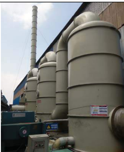
15600 石墨化车间碱液喷淋系统（三级）
