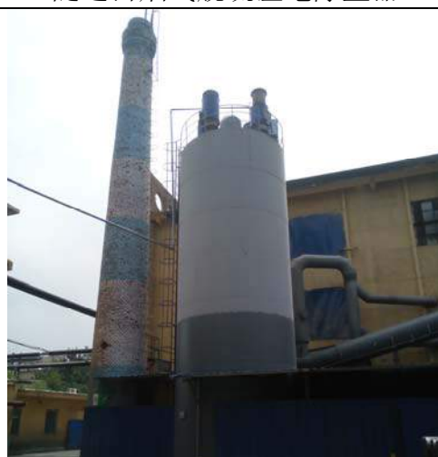
浸渍车间湿电除尘器及排气筒
